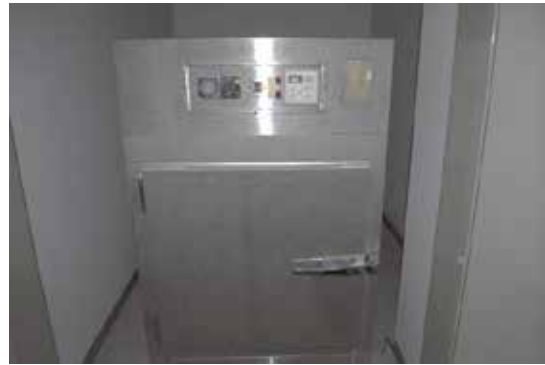
八丈町火葬場の霊安室
