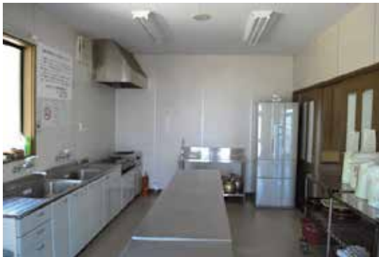
大島町火葬場の式場棟の厨房
