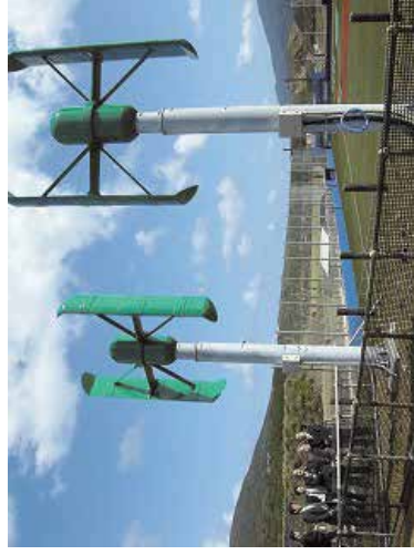
八丈島で島チャリやEVレンタカーに 電力を供給している小型風力発電機 (出力3kW×3基)
